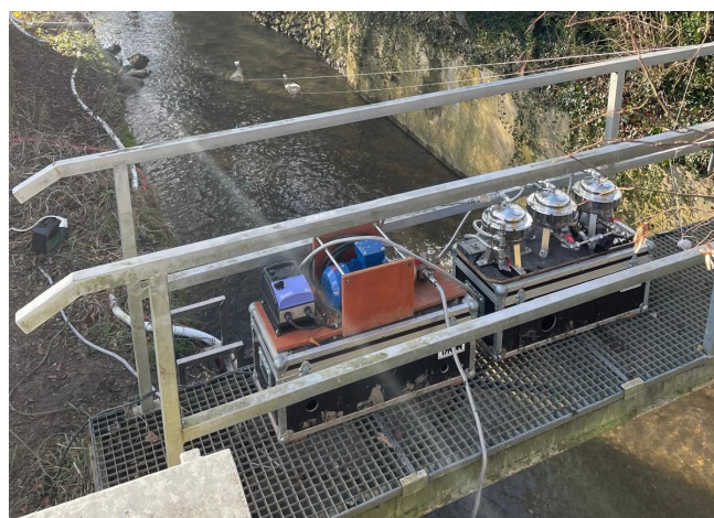
Figure 2 Dispositif de pompage à filtration in situ (UFO) utilisé pour réaliser les prélèvements de MPs à l'exutoire du bassin versant des Avenelles.
